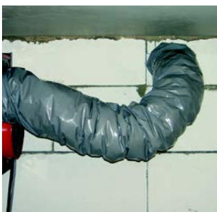
Korrekt montering, svak bøy.
